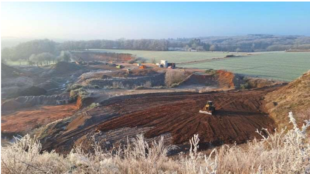
Blick von Südost nach Nordwest über die Fläche des geplanten Vorhabens im Januar 2025 - © Jessica Seibel
